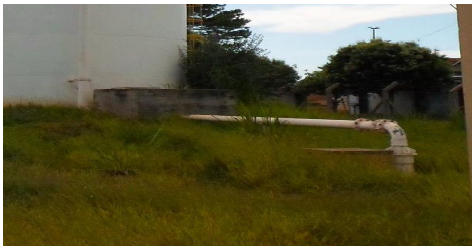
Foto 5 – Poço Monte Sereno
