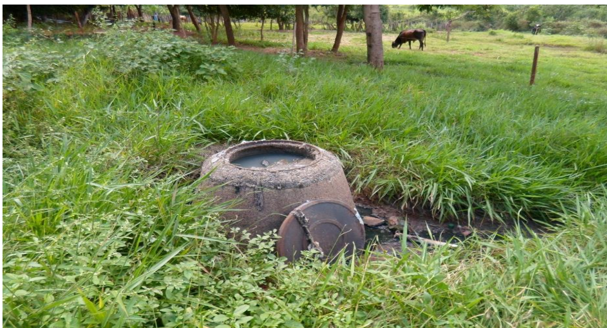
Foto 6 – Poço de visita transbordando Engecorps e Maubeltec, 2015 p.64
